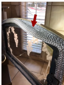
Deficient wood stove door gasket
