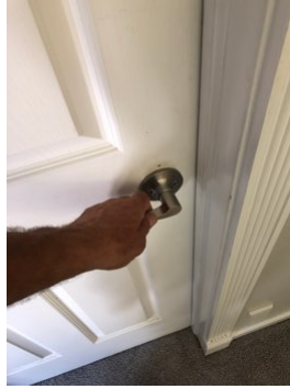
Deficient door latch
