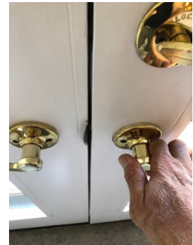
Deficient door latch
