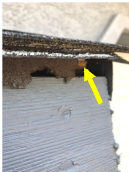
Missing edge flashing
