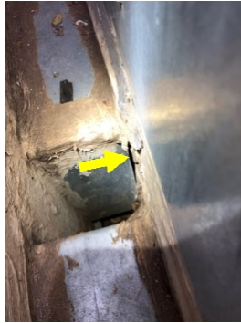
Deficient plenum seal
