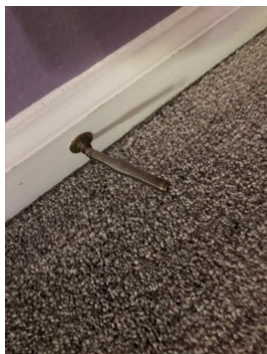
Deficient bedroom 3 door stop
