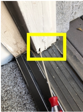
Door jamb wood decay
